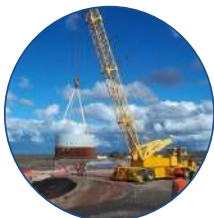
Equipos de carga y izaje
